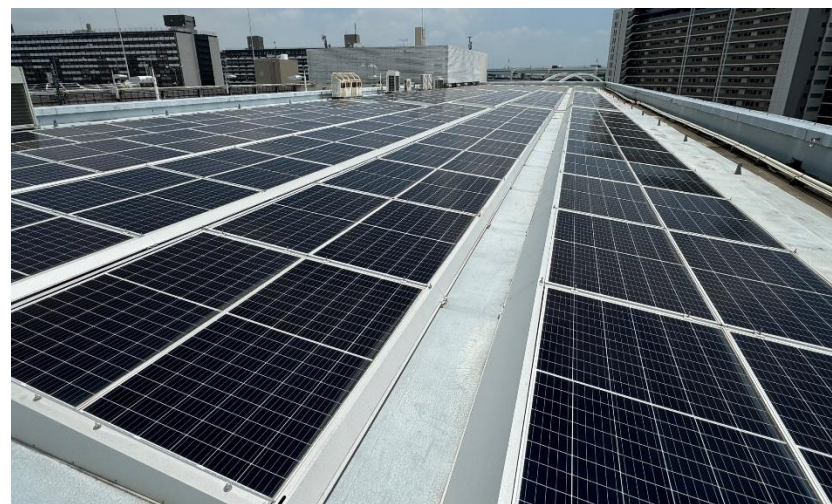
王子流通センター3号館の太陽光発電パネル
